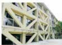
地震で大きな揺れにより、建物が大きく揺れ、倒壊の恐れがある。
